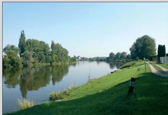
Deich mit Wegbefestigung - Beeinflussung der natürlichen Dynamik von fluvialen Prozessen an der tschechischen Mittelelbe (Foto: Langhammer, 2012). Hráze a tělesa komunikací podél toku omezující přirozenou dynamiku fluvialních procesů v široké údolní nivě na středním toku Labe (Foto: Langhammer, 2012).
