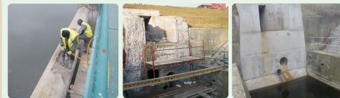
Abbrechen der Überlaufkanten der Hochwasserentlastungsanlage (links), Arbeiten am Ablassbauwerk (Mitte), Ablassbauwerk nach der Fertigstellung (rechts) – Fotos: Povodí Labe, státní podnik
