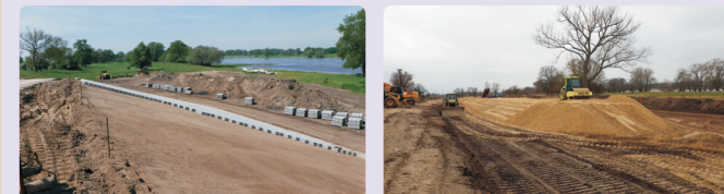
Verlegung von Betonsteindeckwerk auf der Außendeichböschung (links) und Aufbau des Sandkerns beim Deichneubau in Vietze (rechts) – Fotos: H. König, NLWKN
